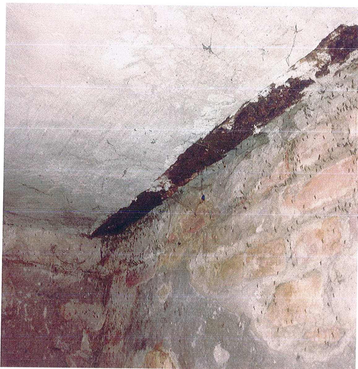
Fot. 6 Skorodowana belka stropowa z widoczną mocno zasoloną ścianą piwniczną – korytarz piwniczny
