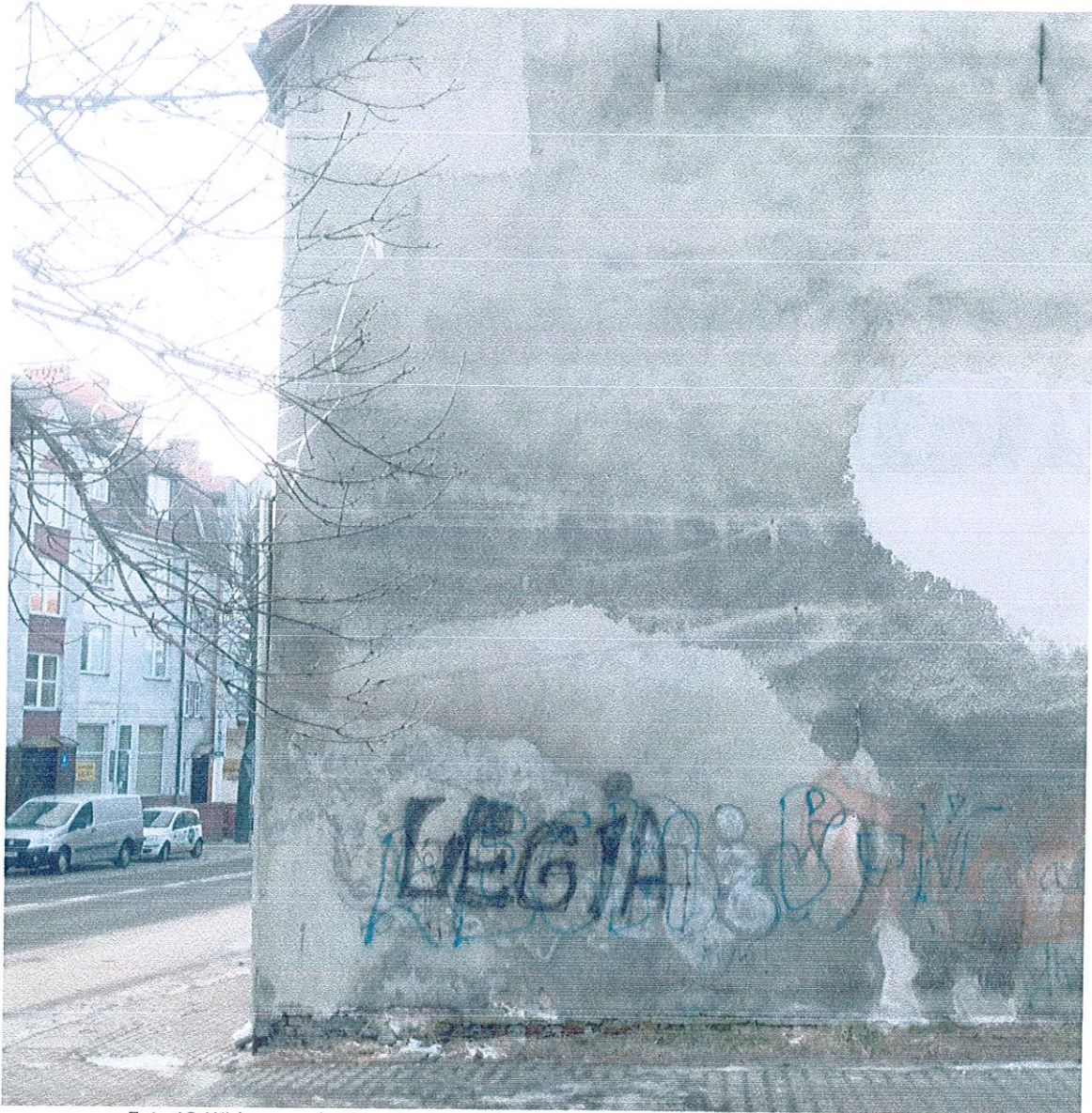
Fot. 12 Widoczne ubytki w tynku w obszarze cokołowym budynku – elewacja boczna
