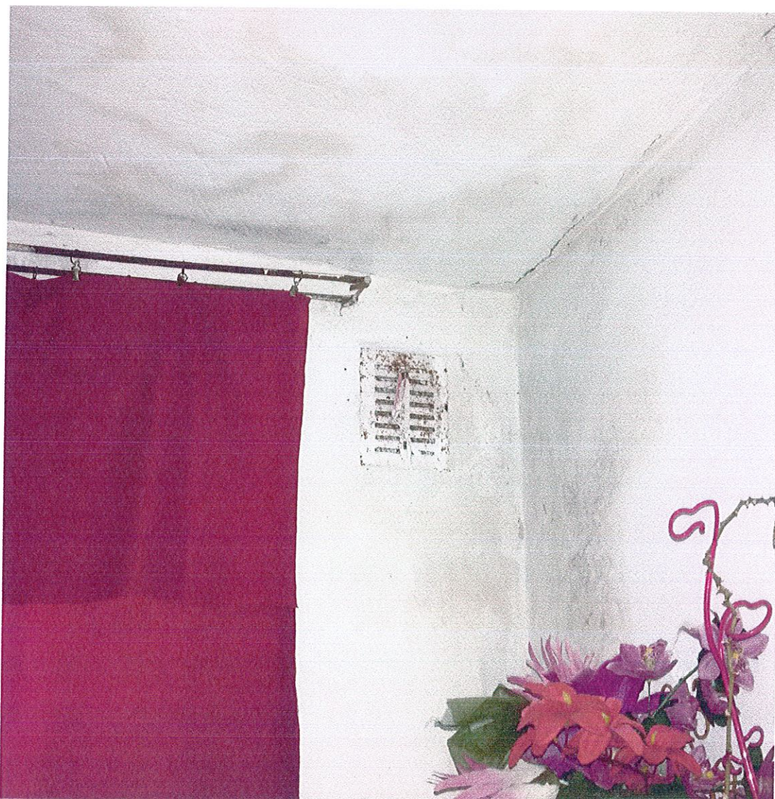
Fot. 21 Widoczne liczne zacieki i wykwyty w mieszkaniu na parterze nr 2 na ścianie od strony podwórza /częściowo zalanie stropu spowodowane najprawdopodobniej zalaniem w obrębie toalety na 1 piętrze/
