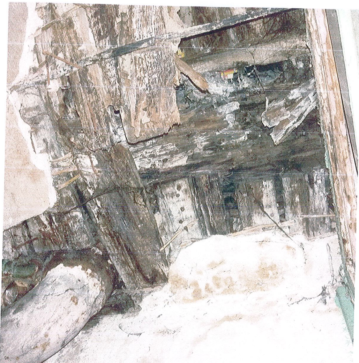
Fot. 17 Widoczny bardzo zły stan techniczny belek stropowych oraz desek podsufitki, jak również podłogi w obrębie sufitu / podłogi w toaletach na korytarzu na 1 i 2 piętrze
