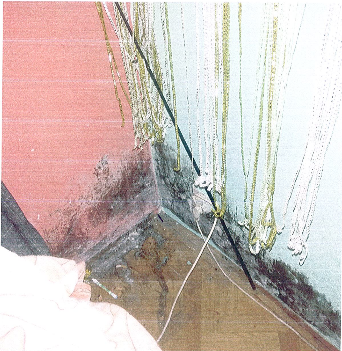
Fot. 23 Widoczne wykwyty w postaci czarnego nalotu w narożniku ściany szczytowej / tylnej w mieszkaniu na 1 piętrze nr 5
