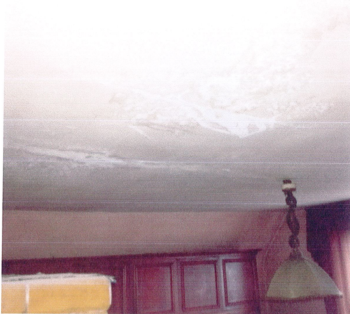
Fot. 19 Widoczny sufit wielokrotnie zalewany w mieszkaniu na poddaszu nr 10
