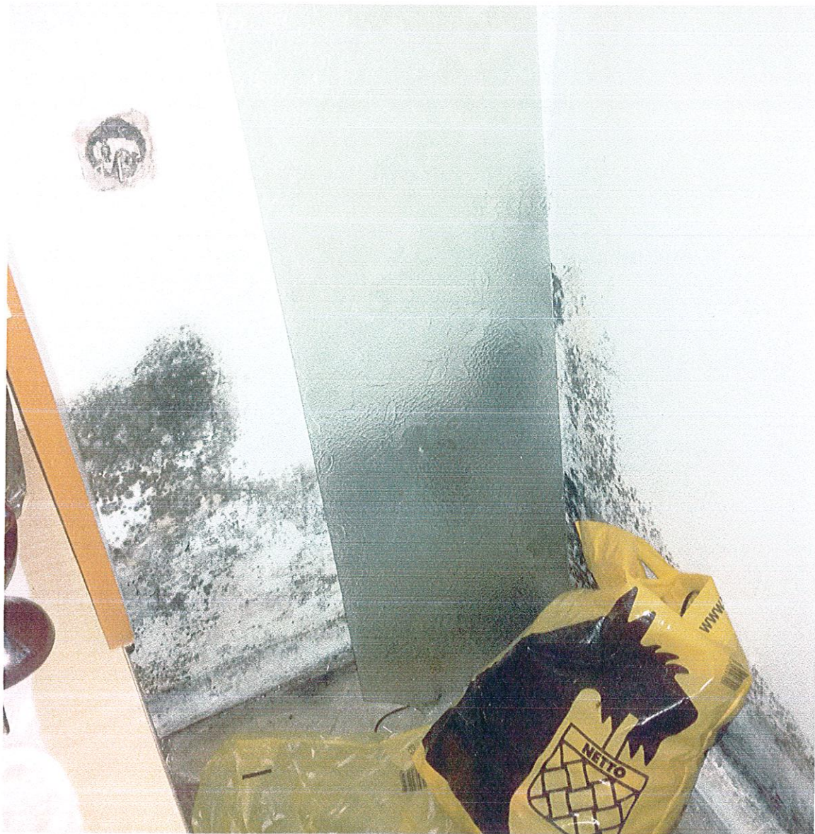
Fot. 22 Widoczne wykwyty w postaci czarnego nalotu na ścianie szczytowej w mieszkaniu na parterze nr 3
