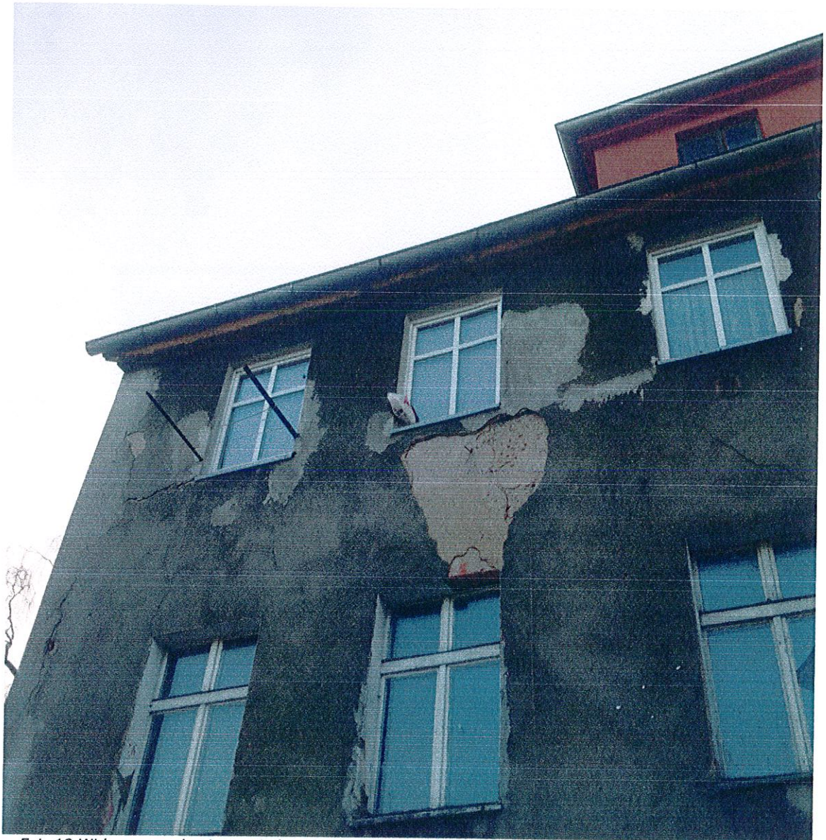
Fot. 10 Widoczne spękania pomiędzy oknami między 1 i 2 piętrem oraz ubytki w tynku- elewacja tylna
