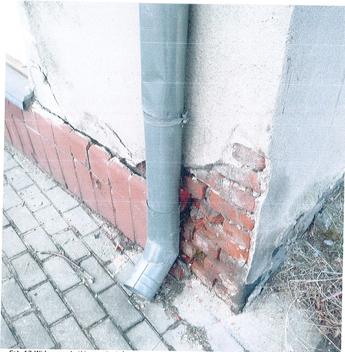
Fot. 13 Widoczne ubytki w cegle, luźne cegły, zawilgocona ściana, odspojony cokół – elewacja frontowa
