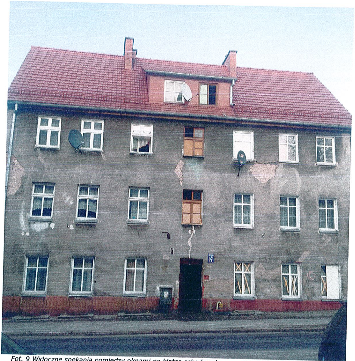
Fot. 9 Widoczne spękania pomiędzy oknami na klatce schodowej oraz w narożnikach budynku – Elewacja frontowa
