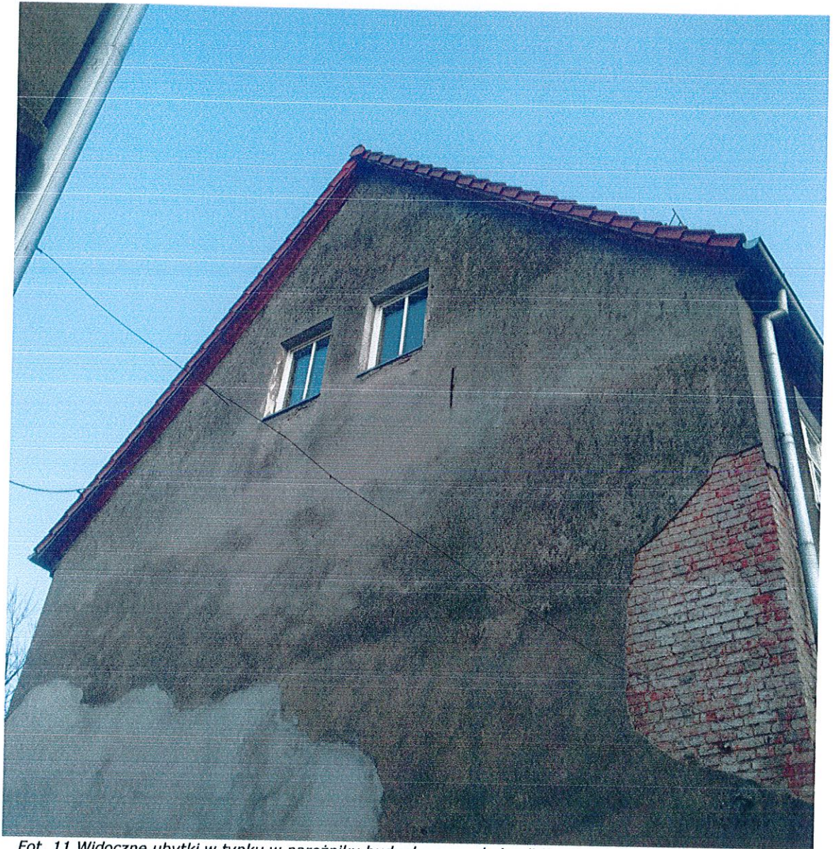
Fot. 11 Widoczne ubytki w tynku w narożniku budynku przy ul. Armii Krajowej = elewacja boczna
