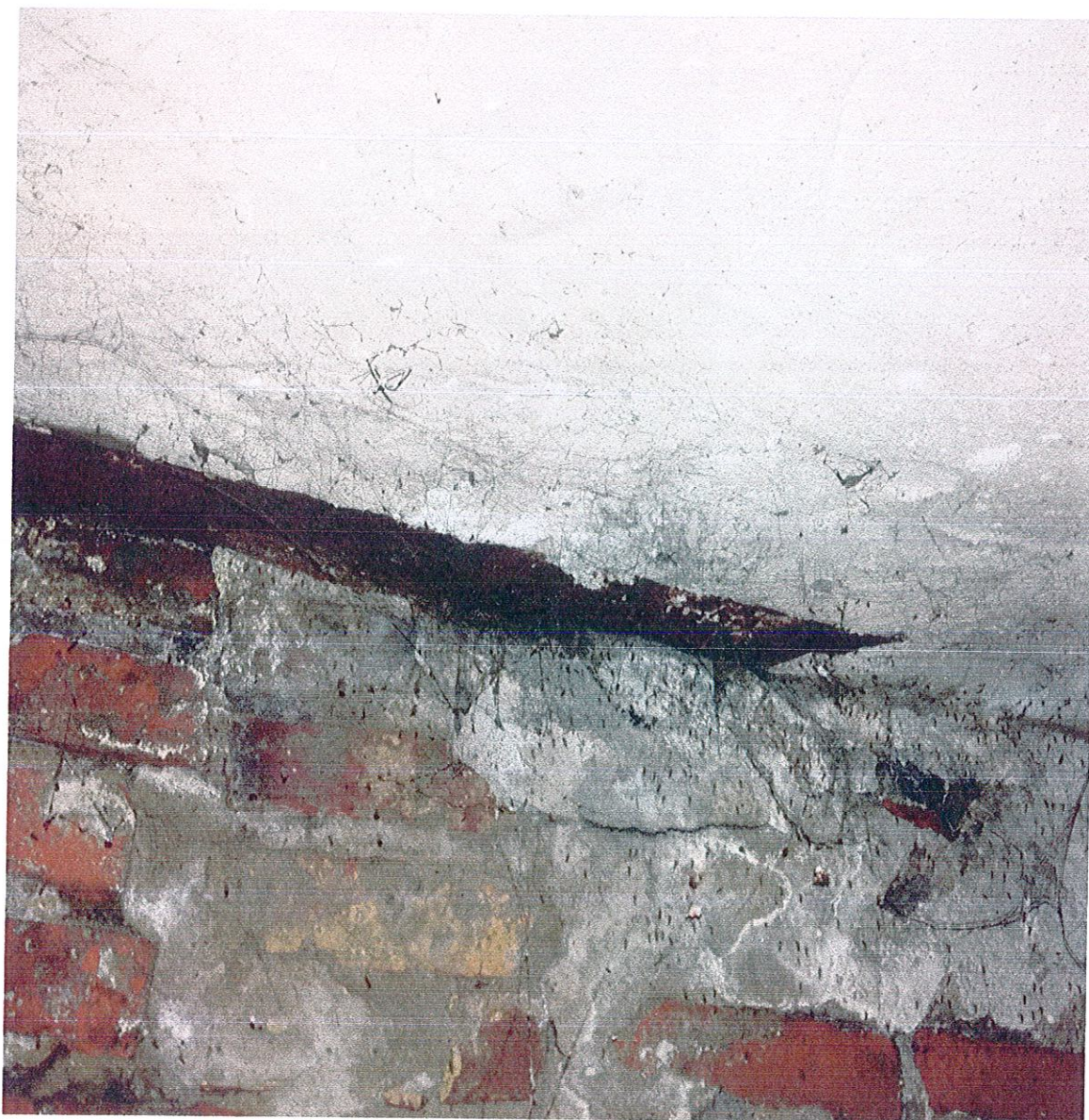
Fot. 8 Skorodowana belka stropowa – pomieszczenie nr 1
